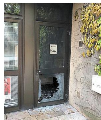
Une vitre du hall d'entrée a été cassée et un engin incendiaire jeté à l'intérieur.
